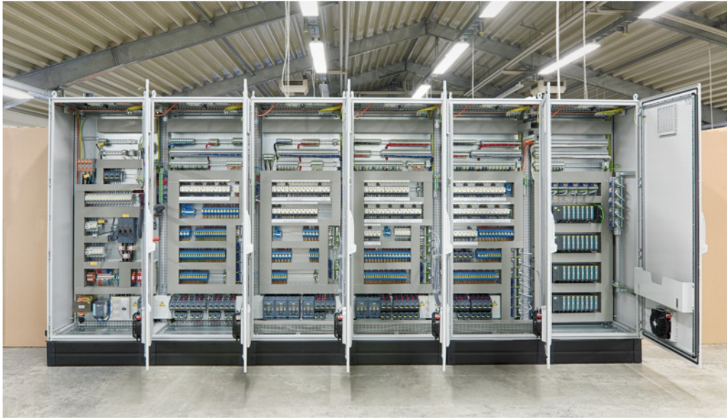
Schaltanlagen aus dem Hause Jokiel sind weltweit im Einsatz.
